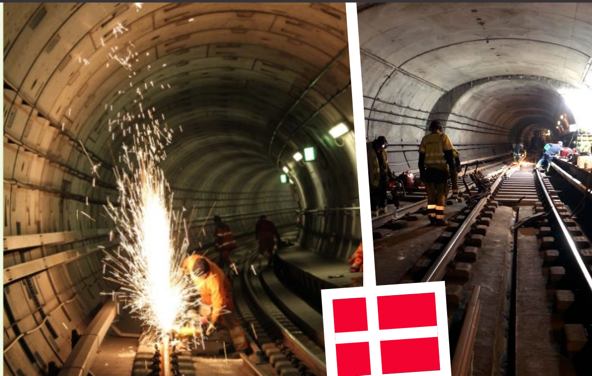
■ STG-personal byter räler och svetsar i tunneln på Metron i Köpenhamn. I framtiden kan det bli fler uppdrag i Danmark.
